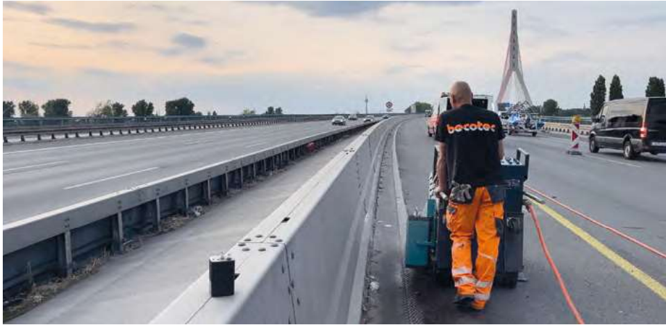
Die Firma Becotec aus Mönchengladbach übernimmt 1.000 Meter Trennschnitte im Asphalt bei der Deckenerneuerung der BAB 46.
